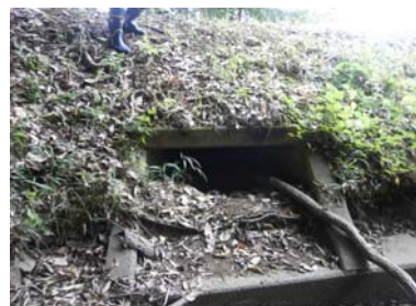
洪水吐に枯葉等が堆積している
