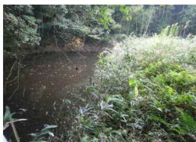
堤防が草で見えない
