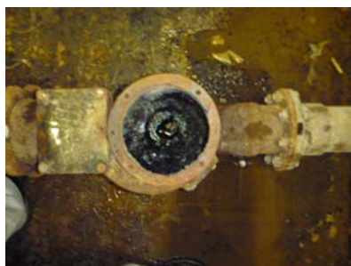
機器(破碎機)の閉塞
