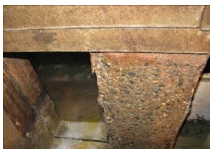
コンクリートの粗骨材の露出、部分的な剥離
