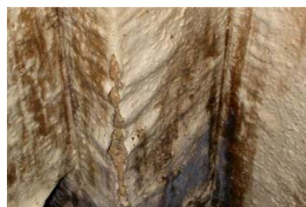
コンクリート防食被覆のふくれ、剥がれ
